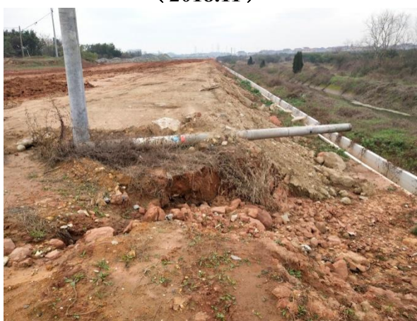
图 1-36 主线路基两侧排水沟现状 (2018.12)
