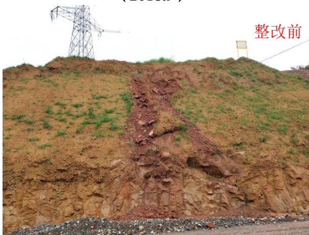
图 1-84 路堑边坡松散小石块滑落 (2019.3)
