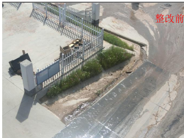
图 1-84 施工场地结束后未拆除 (2019.11)
