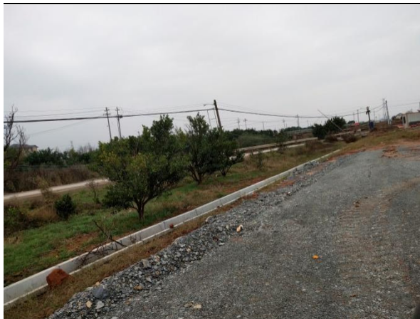
图 1-34 主线路基两侧排水沟现状 (2018.11)
