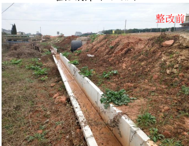
图 1-82 排水沟存在较多淤积物 (2018.9)
