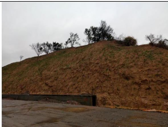
图 1-41 路堑边坡 TBS 防护 (2019.2)
