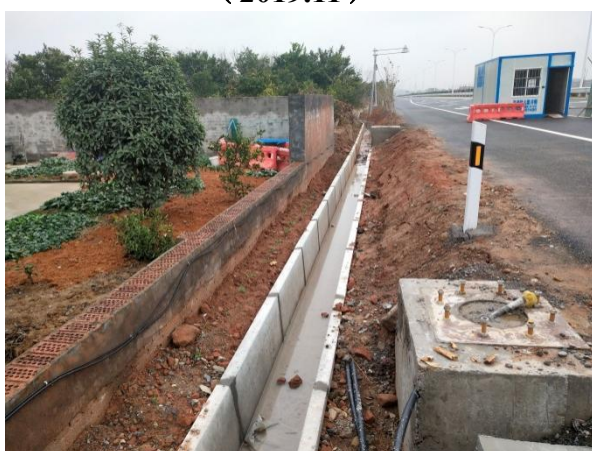
图 1-62 路基两侧排水沟现状 (2020.1)
