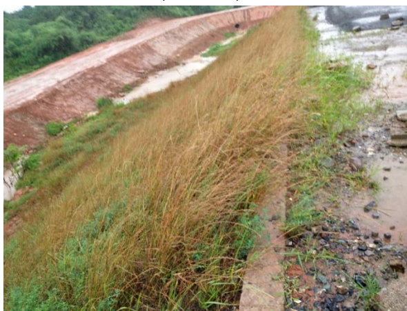
图 1-48 路堤边坡撒播植草现状 (2019.6)
